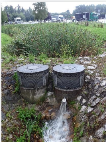
Lovilec olj pri iztoku južnega zadrževalnega bazena, AC Lopata
